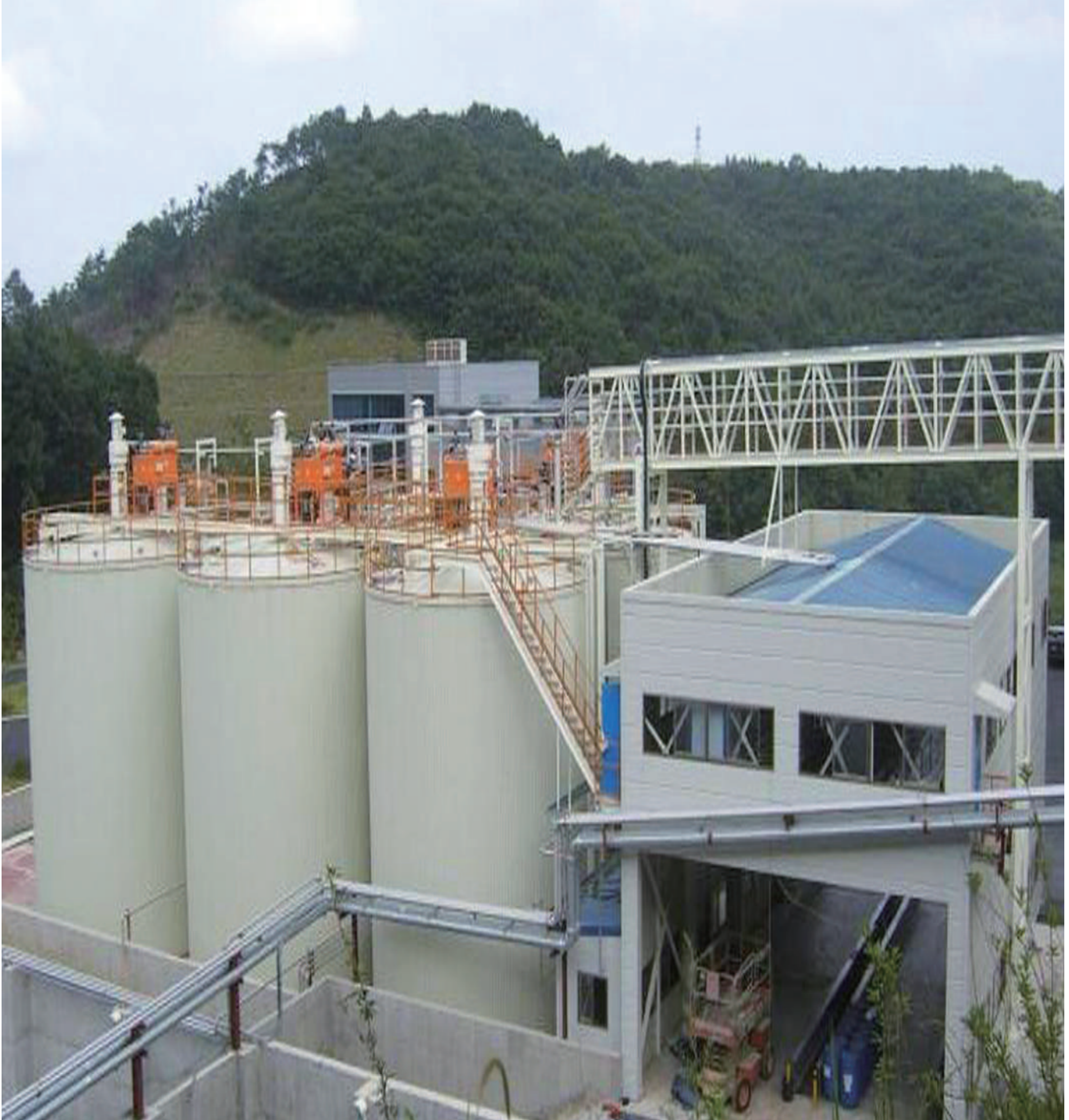
중질탄칼슘탱크 & PIPING LINE 500 TON외 49기
